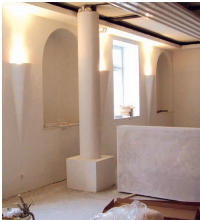
■ ... alle draagbalken, zuilen en scheidingswanden werden met de vochtresistente dragende hardschuimelementen van LUX ELEMENTS bekleed.
