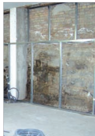
■ Begin van de werken: Voor het vochtige metselwerk werd eerst het regelwerk gemonteerd.
